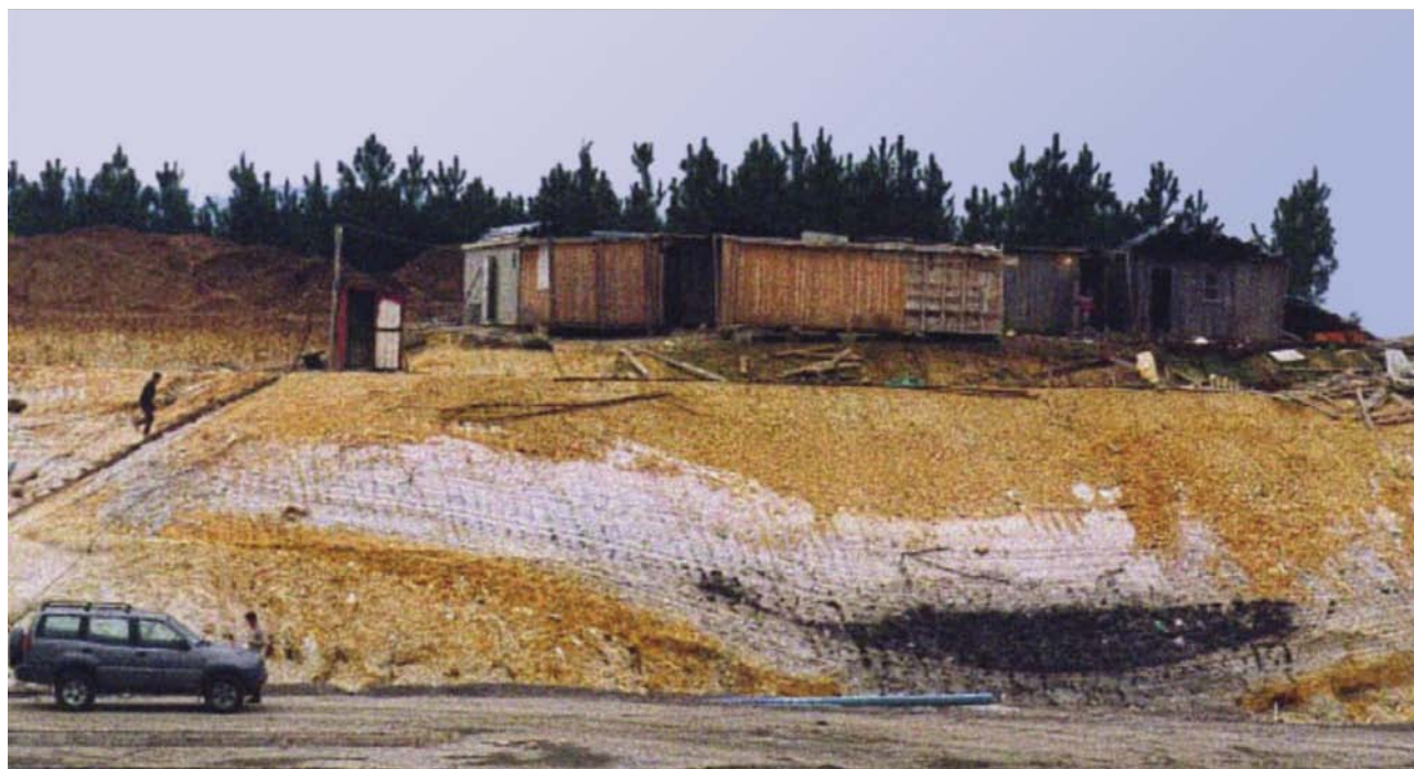
Figura 759. Nivel de arcillas negras pliocenas descubiertas en el talud de la autopista portuguesa A3 a la altura de São Pedro da Torre
